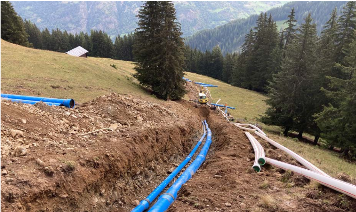
Plusieurs chantiers ont occupé notre équipe, comme ici celui de la construction de la conduite de turbinage sur le tronçon Tseppiet-Renarosse.
