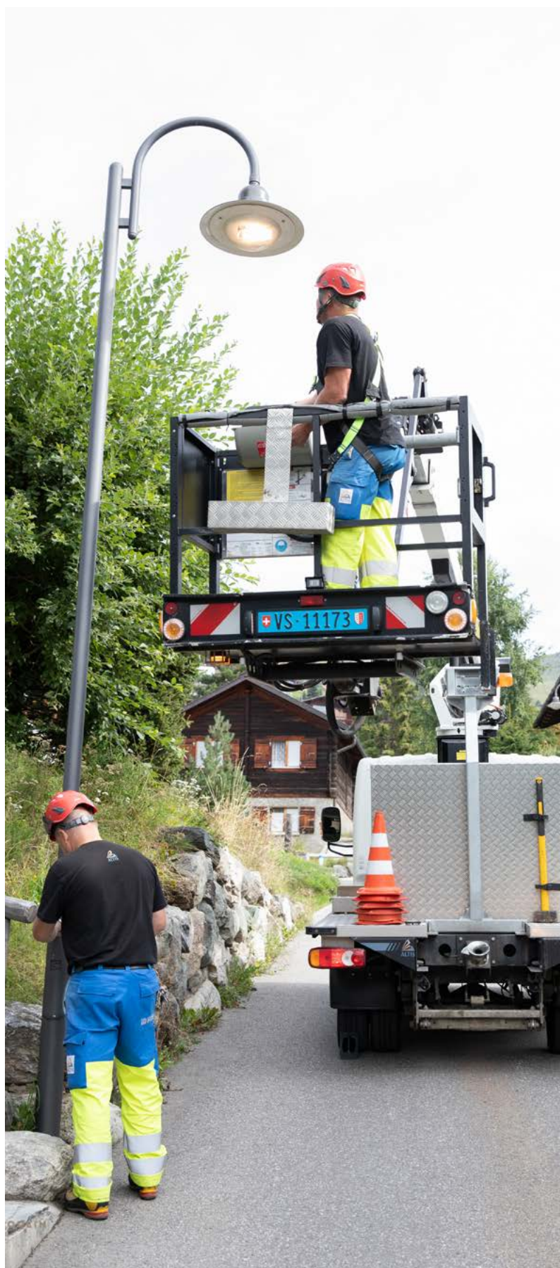
Dans le cadre de la modernisation des infrastructures d'éclairage public, Altis installe exclusivement, depuis 2013, des luminaires LED intelligents.
