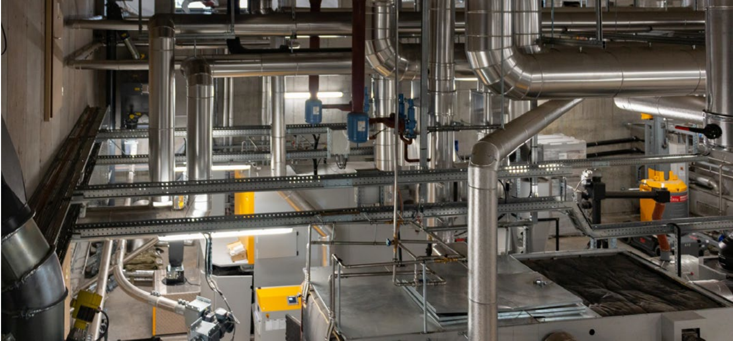
Mise en service au printemps 2021, la nouvelle chaufferie du centre sportif de Verbier nous permet d'augmenter significativement les capacités du CAD sur la station.
